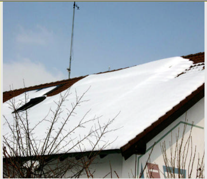
Unter der Schneedecke verbirgt sich eine Solarstromanlage, die trotz Sonnenschein keinen Strom erzeugen kann.
