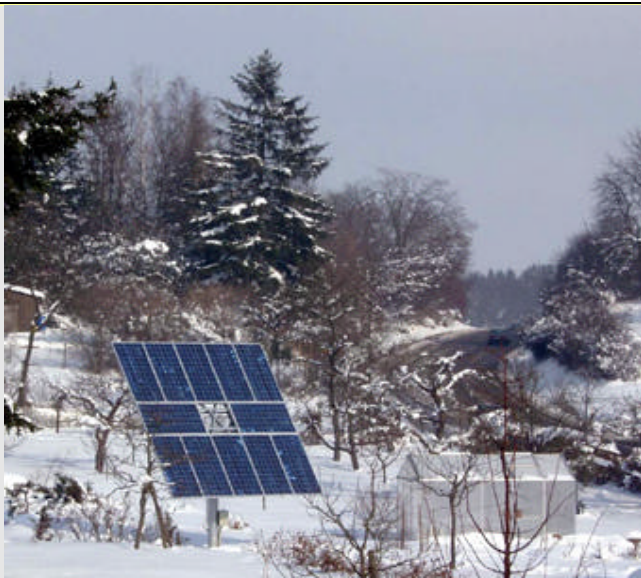
Photovoltaikanlage, die sich automatisch nach der besten Sonneneinstrahlung ausrichtet und leicht zu warten ist.
